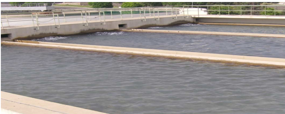
Photo 6 : filtre à sable
