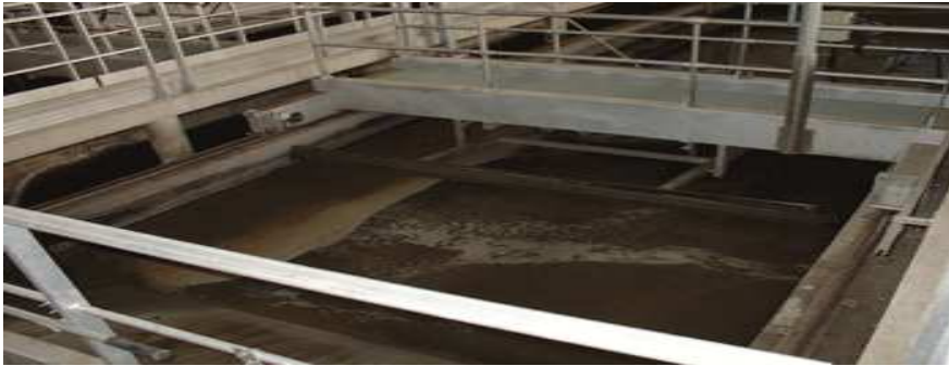
Figure 4: opération de dessablage dans la station de prétraitement
