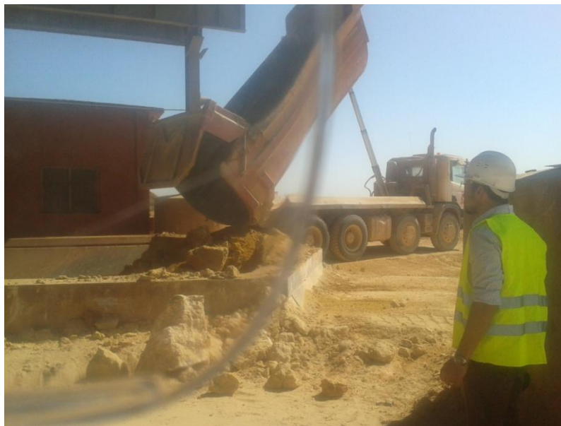
Figure 3 : décharge de matière premier dans la trémie
