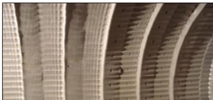
Figure 19: image de l'état du blindage de la deuxième chambre
