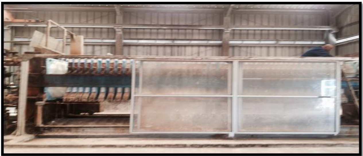
Figure 10 : La station de désucrage des boues
