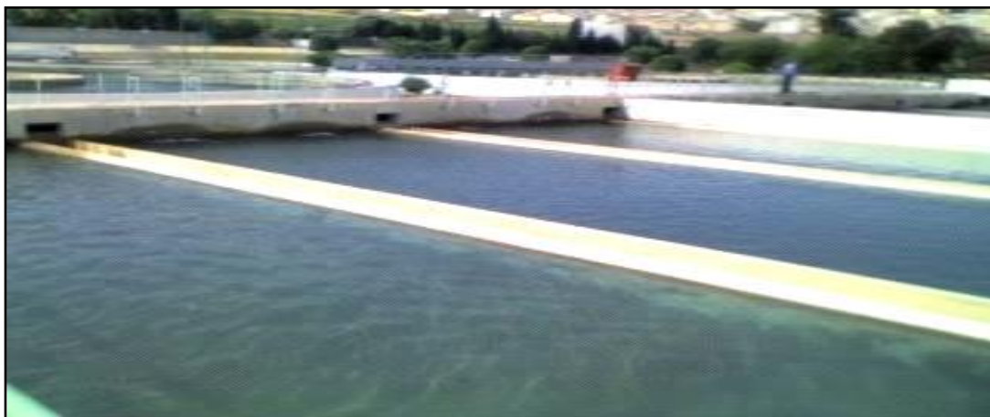
Photo 6 : les filtres à sable.
