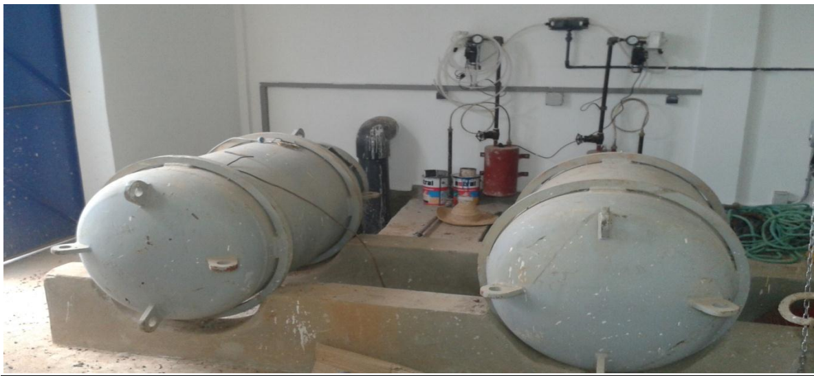
Photo 10 : Tanks de chlore
