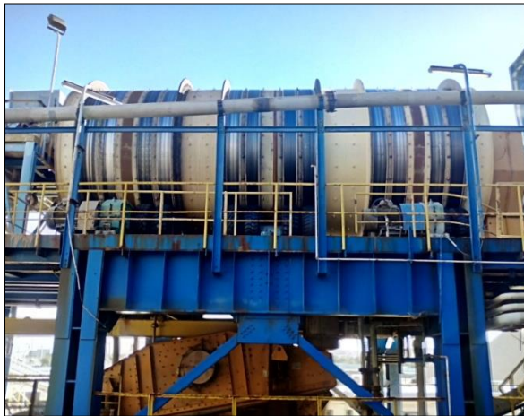
Figure 1 : Le débourbeur (Trommel 30)
