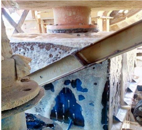
Figure 17 : Débordement des cuves
