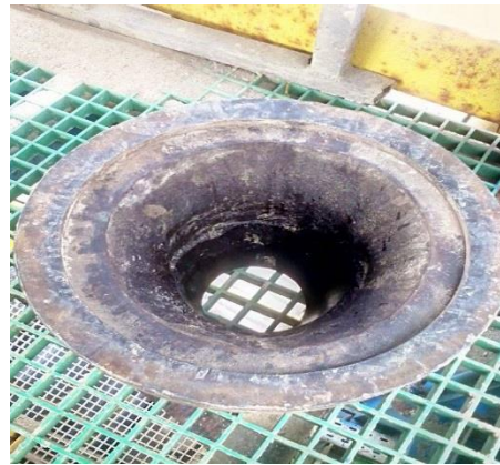
Figure 16 : Dégradation de l'apex
