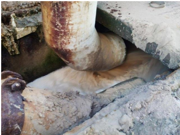
Figure 20 : Les boues argileuses évacuées vers caniveaux
