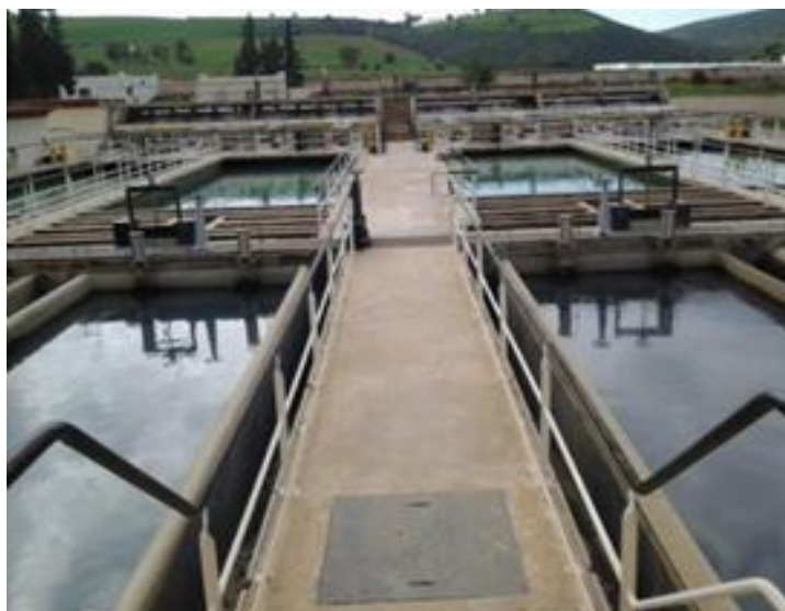
Figure 3 : les bassins de filtration à sable
