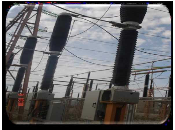
Figure 29 : disjoncteur de travée
