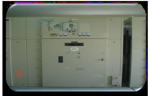
Figure 39 : Cellule de l'arrivée transfo 33/225KV
