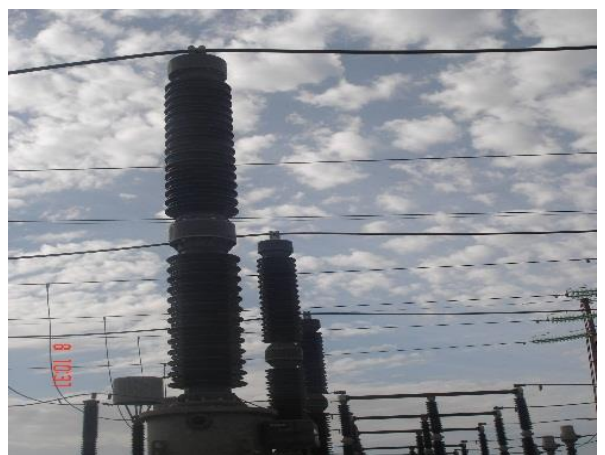
Figure 30 : transformateur de tension
