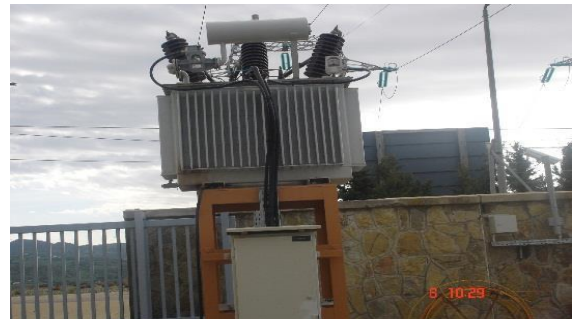
Figure 32 : transformateur des services auxiliaires
