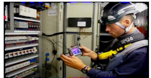
Figure 41 : Technicien réalise la maintenance préventive
