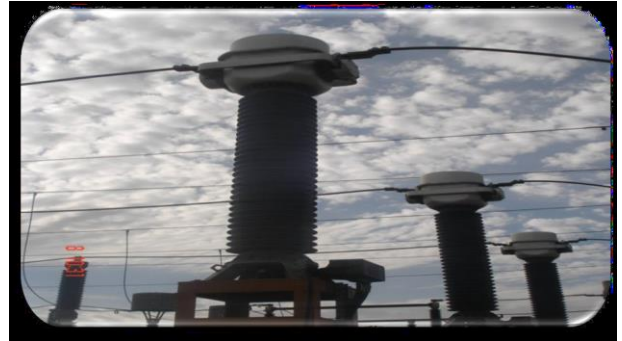
Figure 31 : transformateur du courant
