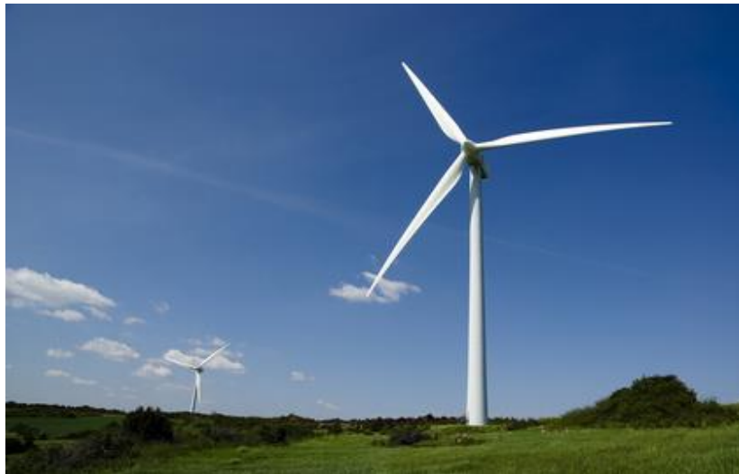
Figure 6 : éoliennes classique les plus utilisées à 3 pales
