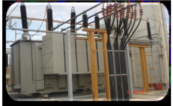
Figure 28 : transformateur de puissance 100 MVA
