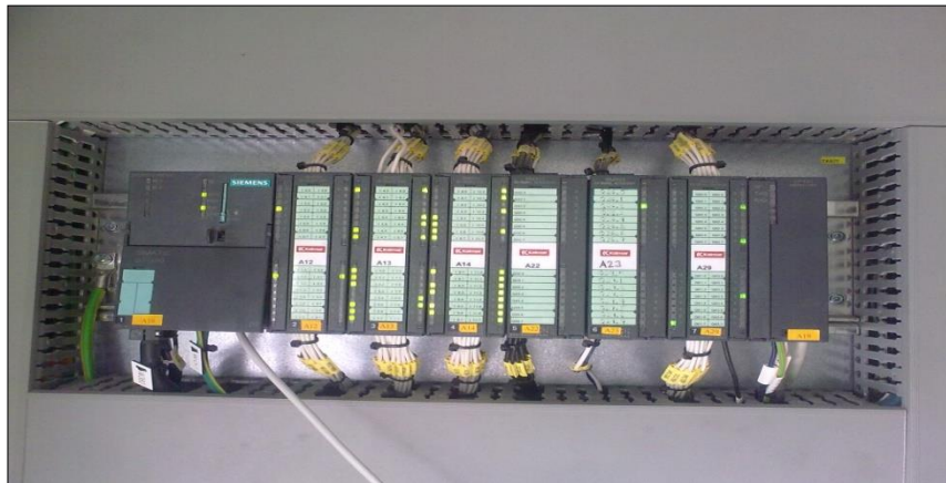
Figure 15: API S7-300 de siemens du portique RTG
