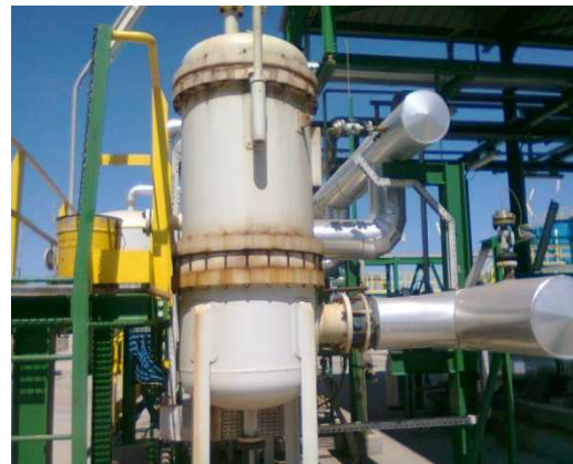
Figure 23 : Filtres à cartouches de la station
