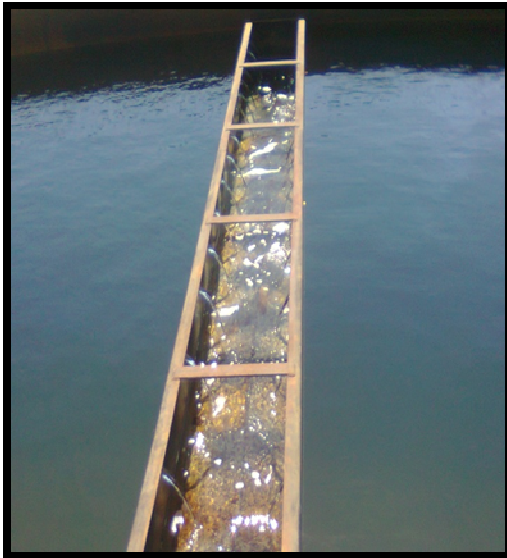
Figure 19 : Goulottes de récupération des eaux clarifiées
