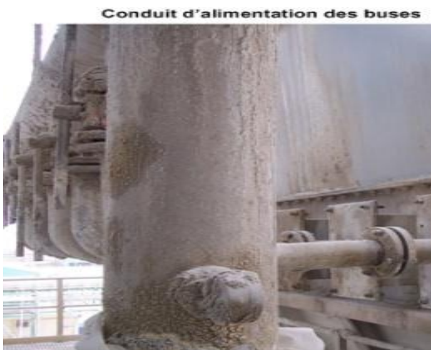
Figure 20:les conduits d'alimentation des buses
