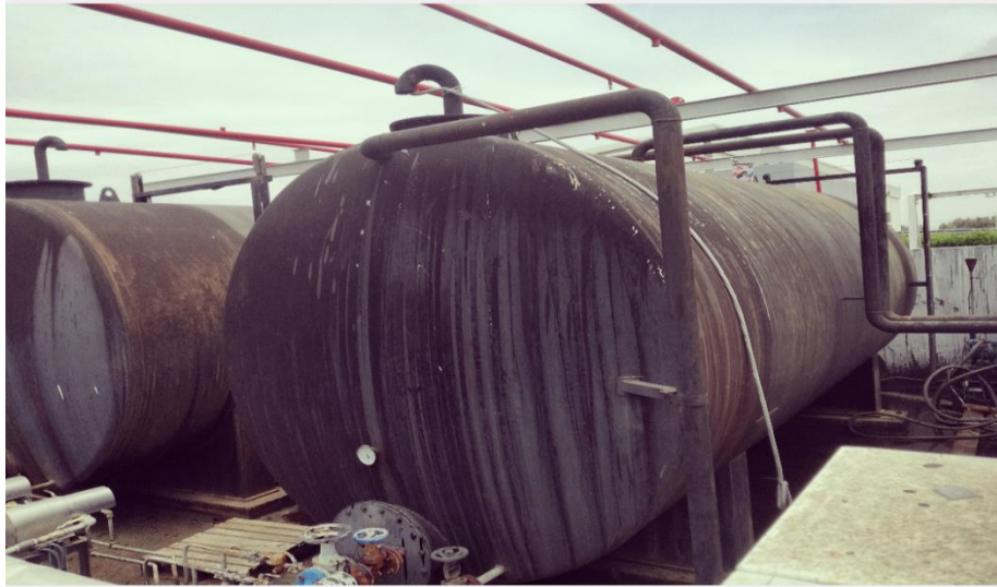
Figure 10: Citerne de stockage de Fuel du local chaufferie de la société CHERGUI
