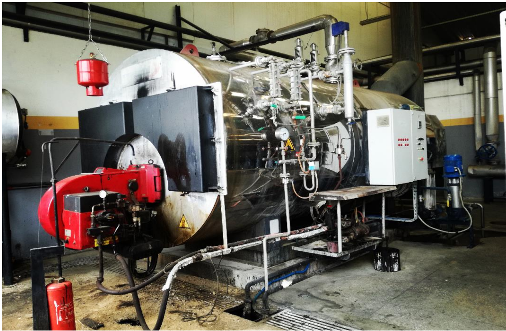
Figure 12: Chaudière du local chaufferie de la société CHERGUI
