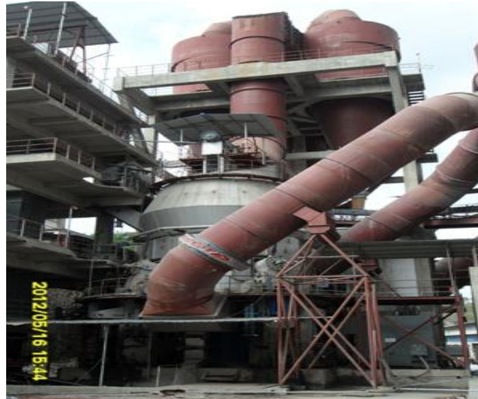
Figure 15 : broyeur vertical du charbon
