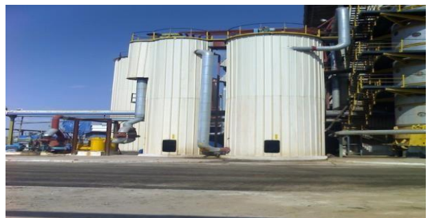
Figure 8 : Constitution d'un préchauffeur et bacs de préchauffage et chaulage
