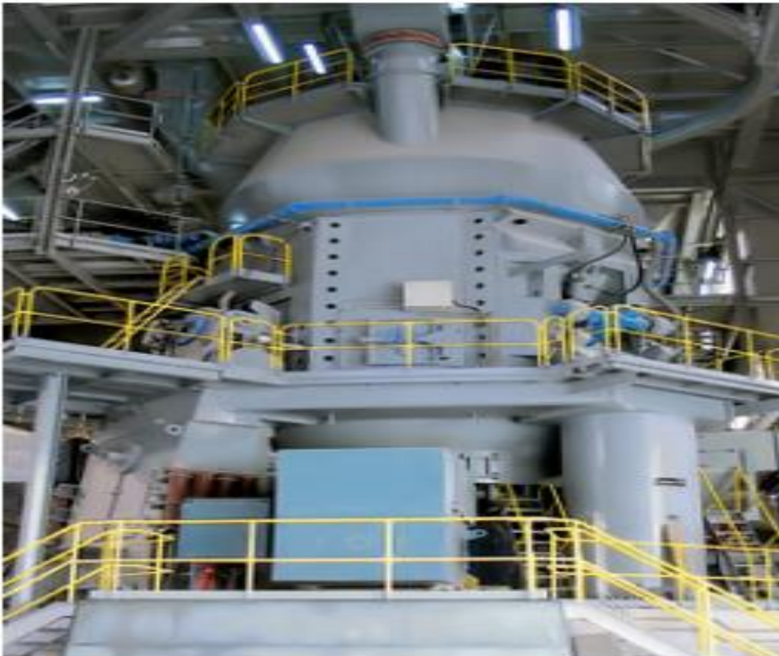
Figure 7: Broyeur du ciment de la société Holcim-Fès
