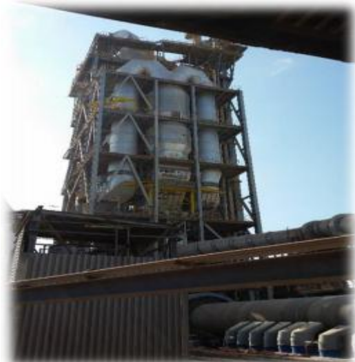
Figure 6 : Tour de préchauffage (Tour DOPOL)
