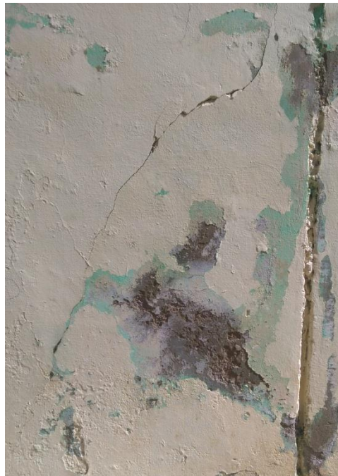
Figure 56 . Humidité et fissuration causées par l'absence de drains
