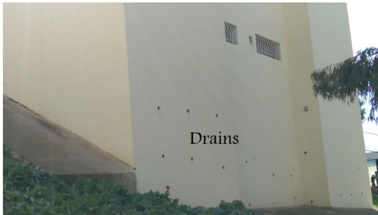
Figure 57 : Drains au niveau des constructions
