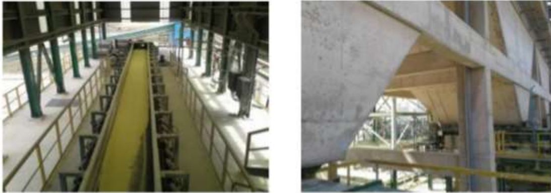
Figure 7: chariot verseur (RE_3) avec les trémies de stockage de soufre
