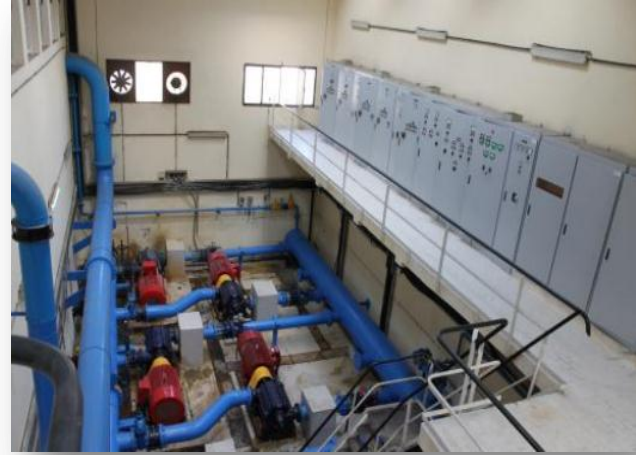
Figure 11 : Pompes de refoulement
