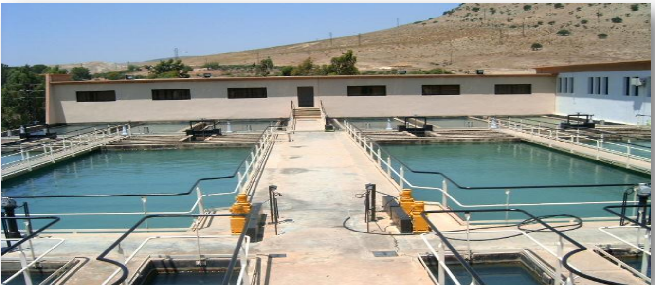
Figure 4 : Station de traitement des eaux El Kansera
