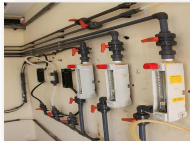
Figure 10 : Salle d'injection du chlore
