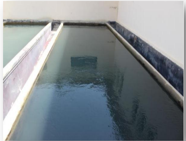
Figure 9 : Filtre à sable
