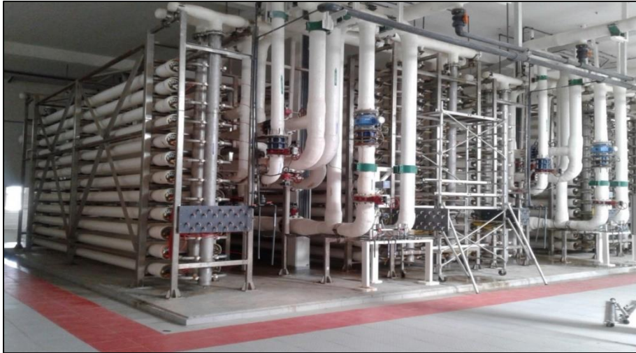
Figure 14 : osmoseurs inverses (dessalement de l'eau)
