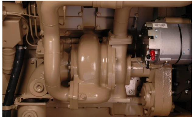
Figure 45: emplacement des pompes à eau dans le moteur
