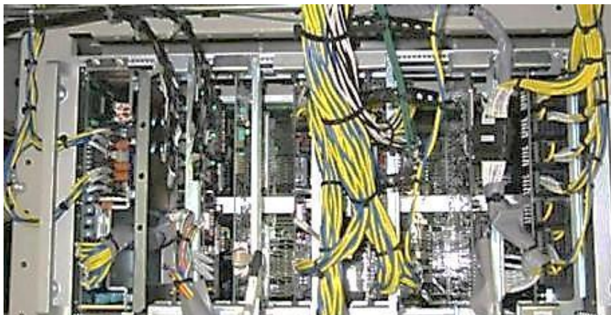
Figure 33: contrôleur du système de commande.
