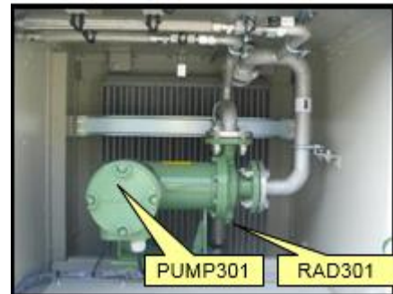
Figure 37: pompe de refroidissement de l'armoire de commande et son radiateur.
