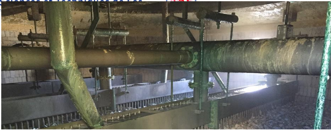
Figure 34 : Apparition des sulfates sur le système de distribution
