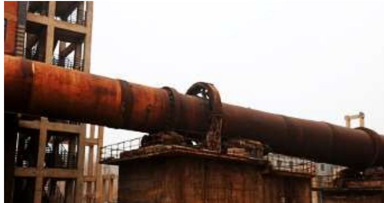
Figure 8: Four rotatif d'usine de Meknès
