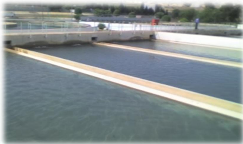
Figure 3 : Les filtres à sable dans la station de traitement
