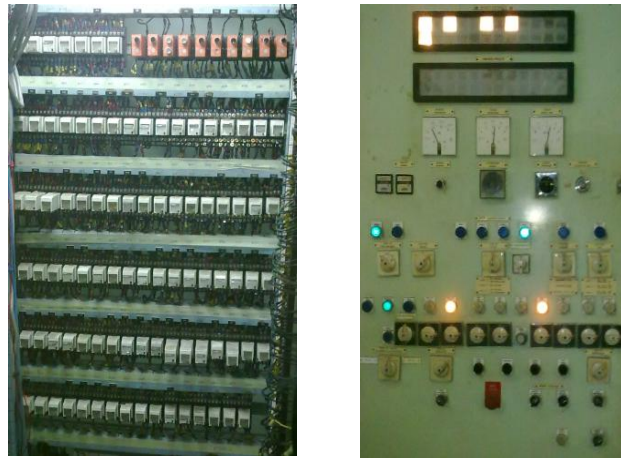
Figure 2.8 : Armoire de commande
