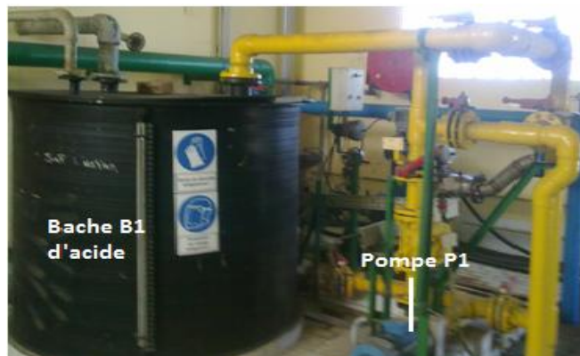
Figure 5.12 : Poste de lavage HCL
