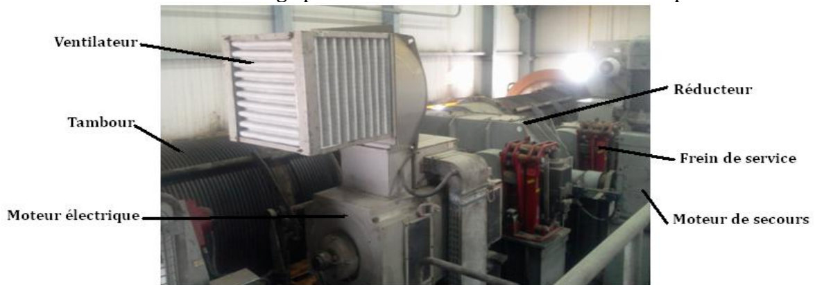
Figure 5 : Salle de machines de levage
