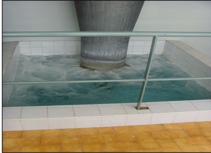
Figure 7 : l'eau après filtration dans la station de traitement
