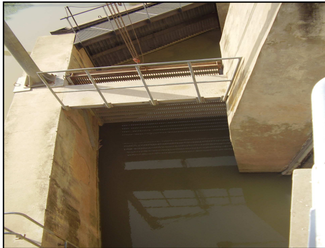
Figure 1 : Opération de dégrillage dans la station de prétraitement
