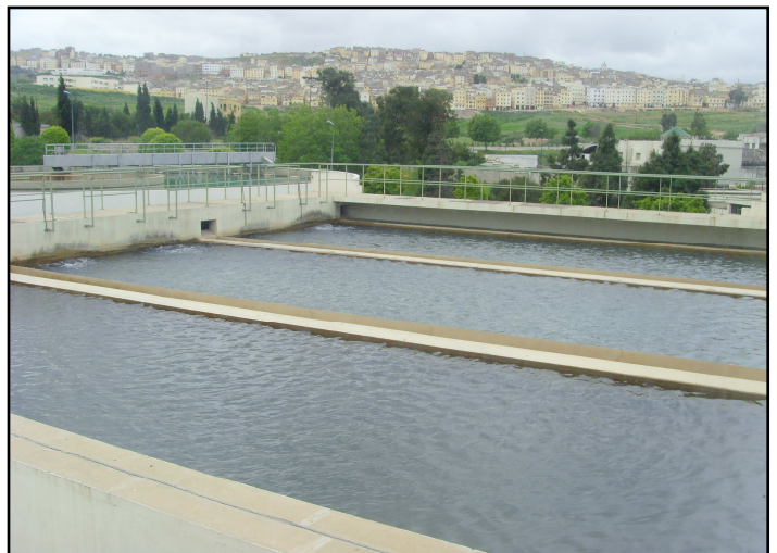
Figure 6 : Opération de filtration dans la station de traitement
