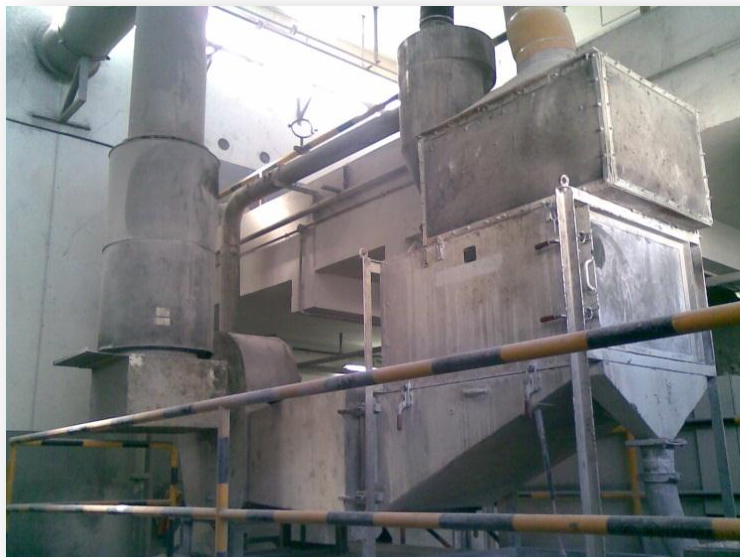
Figure 8. Photo système de refroidissement actuel de Nexans
