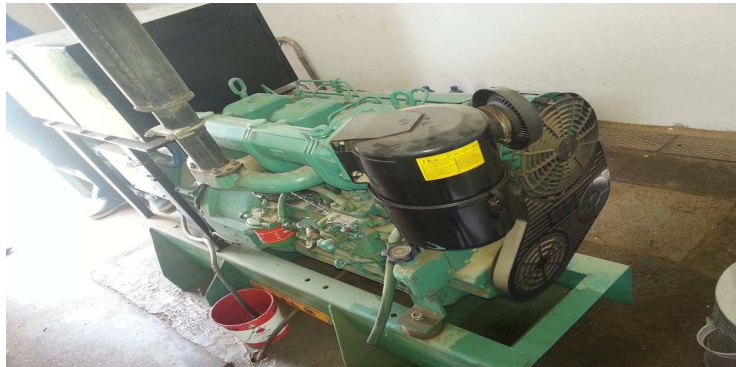
Figure 14:Groupe électrogène de la station VOR /DME
