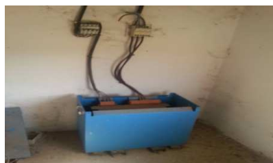
Figure13: Transformateur abaisseur de la station VOR /DME
