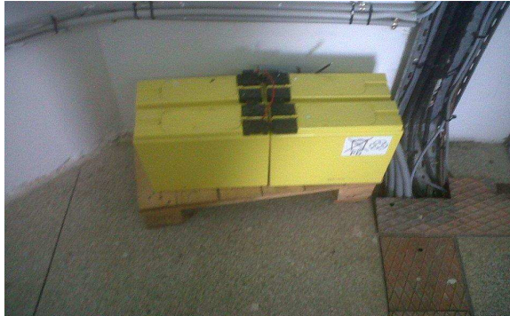
Figure 17 : Batteries de secours
