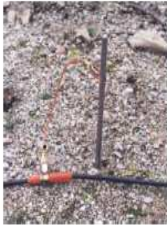
Connexion électrode au câble
