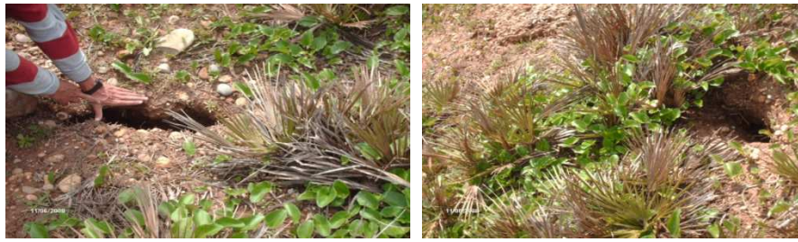
Photo 2-4-3a : Présence de fissures assez larges (10 cm) et profondes dans les glacis
