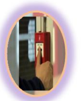
Système d'alarme et gestion d'incendies
