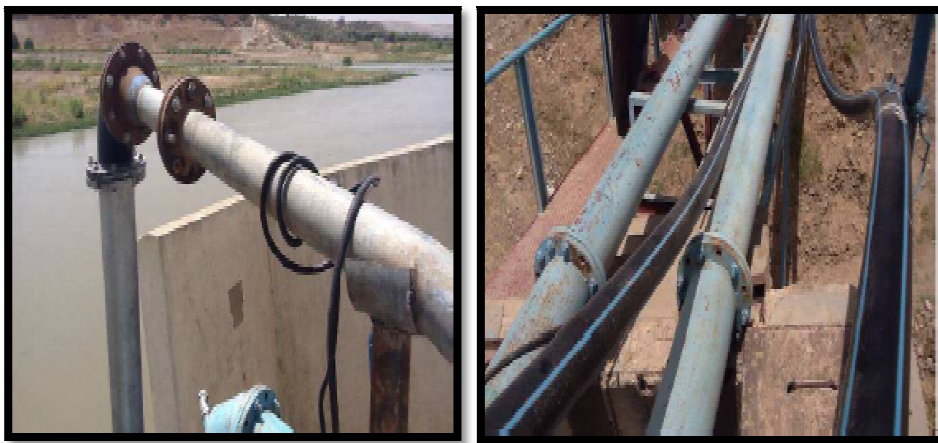
Photo 2 : Le système de pompage direct à partir d'Oued
