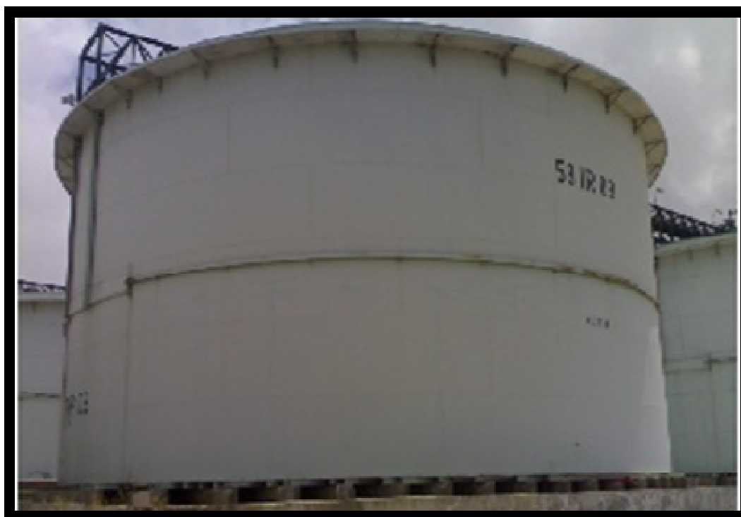
Figure 5: bac de stockage de l'acide phosphorique.
