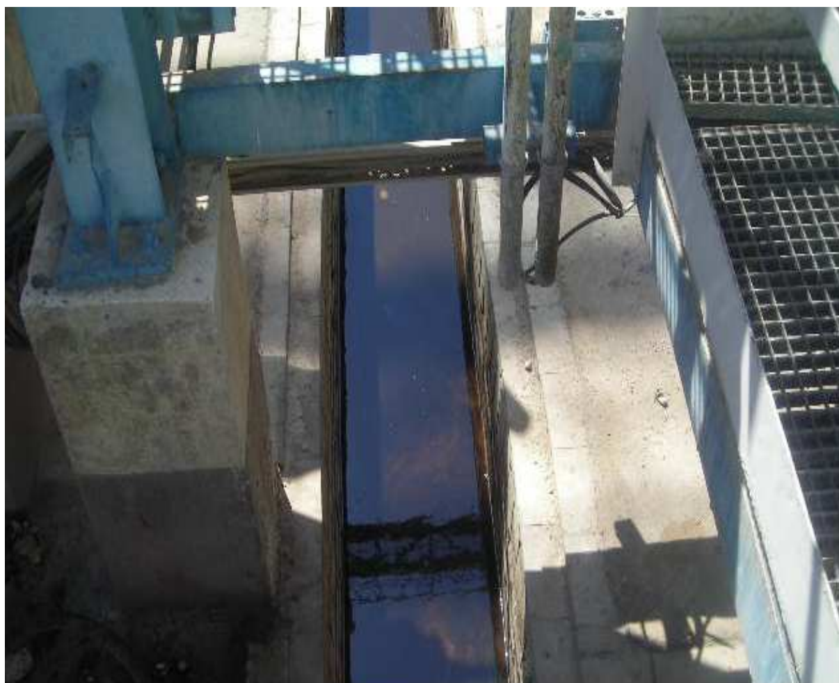
Figure 15 : Caniveaux de canalisation d'acide phosphorique
