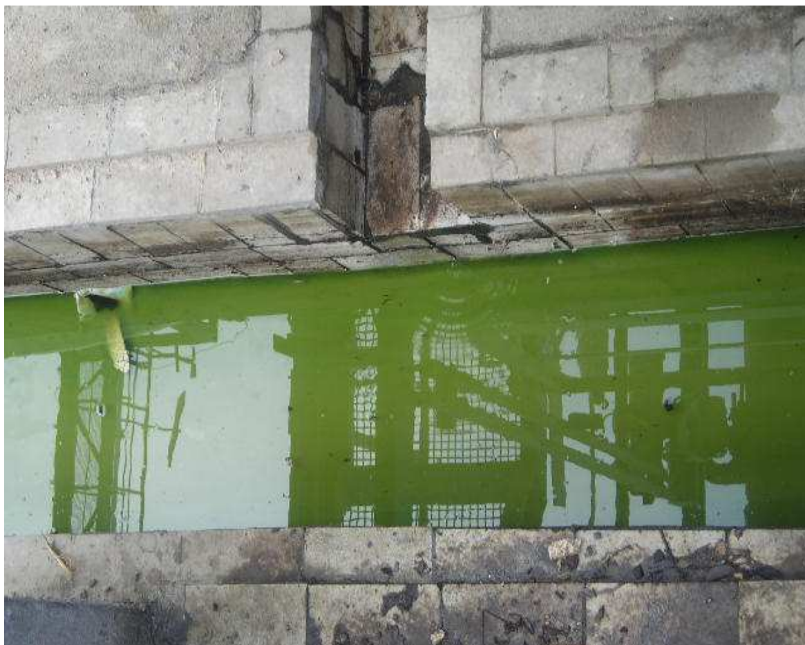
Figure 16 : Caniveaux de canalisation d'acide phosphorique
