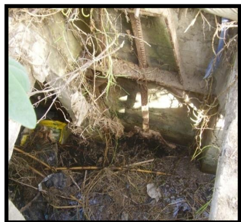
Figure III-12: Vanne clapet de la prise d'eau (non fonctionnelle)
