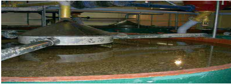
Figure 1: cuve cylindro-coniques de trempage
