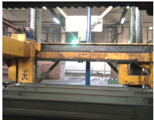
Figure III-2-1-7. Moteur, réducteur et système de transmission pignon crémaillère.
