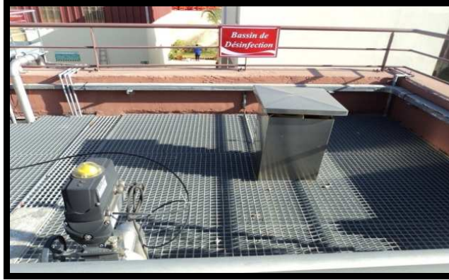
Bassin de désinfection de la STEP de la CBGN
