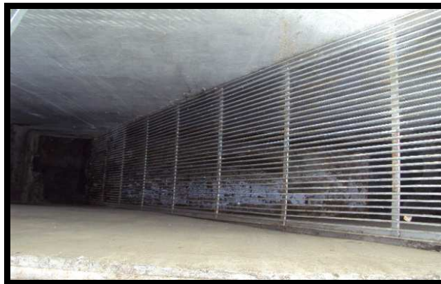
Dégrilleur grossier de la STEP de la CBGN
