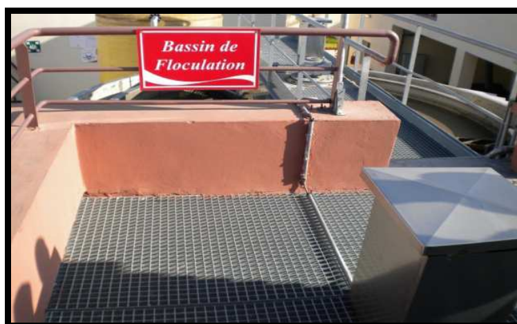
Bassin de flocculation de la STEP de la CBGN
