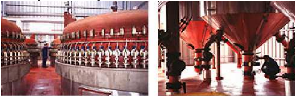
Figure 2 : Filtration mécanique à l'aide de filtres Diasters
