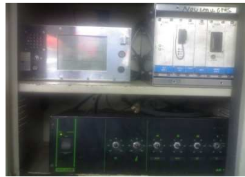
FIGURE 4: EQUIPEMENT DE LA SONORISATION
