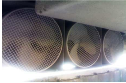
FIGURE 7: LES MOTO-VENTILATEURS DU CONDENSEUR
