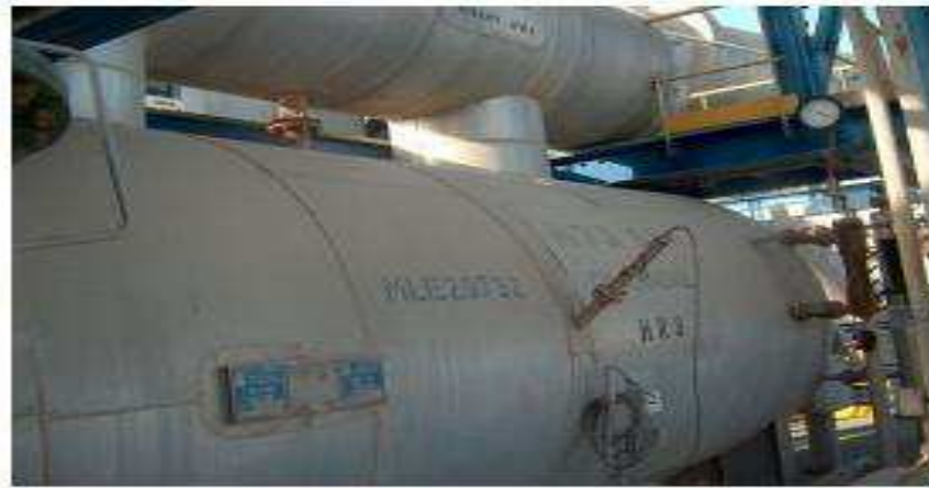
Figure 7: Chaudière de récupération
