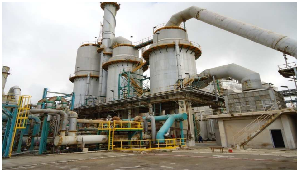
Figure 9: tours, séchage, d'absorption intermédiaire et d'absorption finale Chapitre 1 : Présentation de l'office chérifien des phosphates et du pôle chimie JORF-LASFAR et description de l'Atelier Sulfurique.
