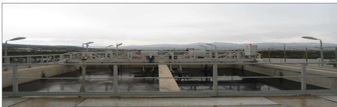
Photo 2: Poste de dessablage-déshuilage
