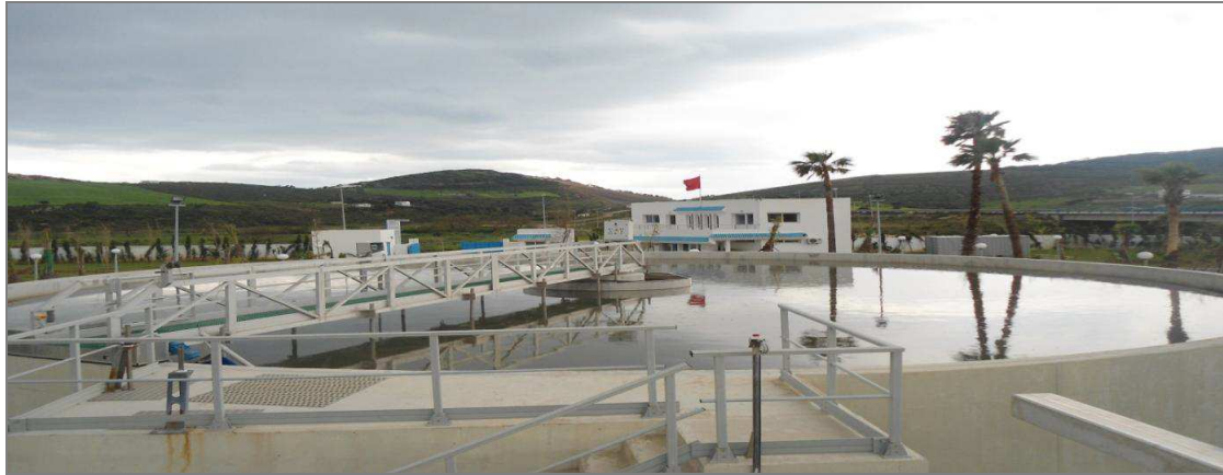
Photo 3 : Le décanteur primaire
