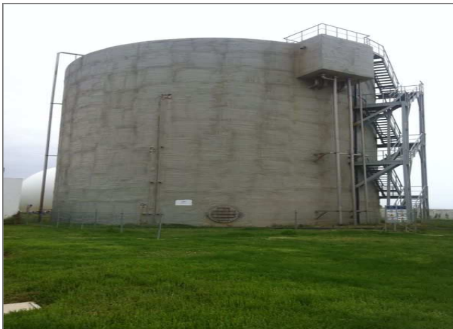
Photo 12: Photographie de Digesteur
