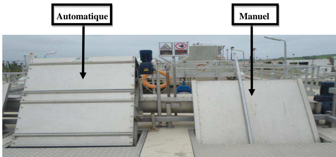
Photo 1: Dégrilleur automatique et manuel
