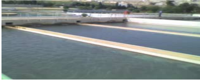
Photo 6 : Filtre à sable.
