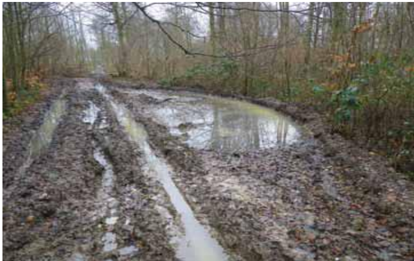
Figure 12 : Dégradation de la piste par l'eau
