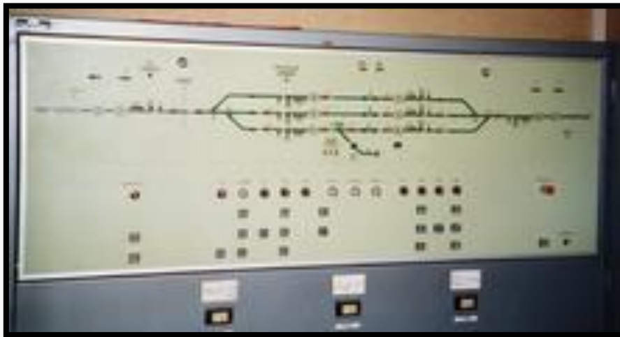
Figure 17 : Tableau de Commande et de Contrôle (TCC)
