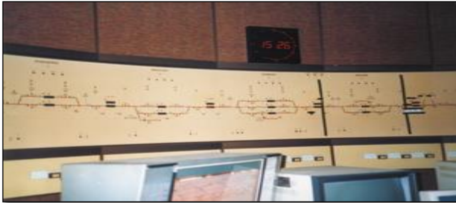
Figure 20 : Salle de contrôle PRS
