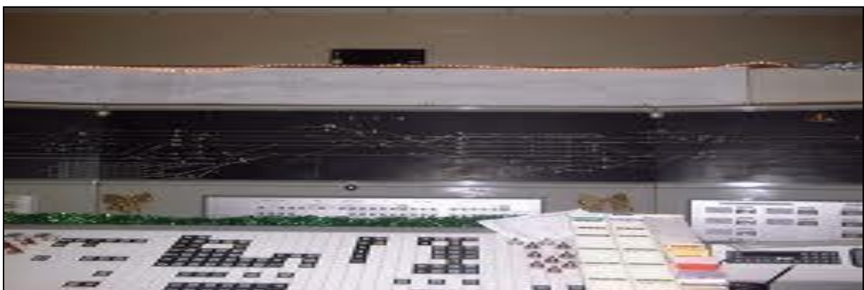
Figure 19 : Poste tout Relais à transit Souple
