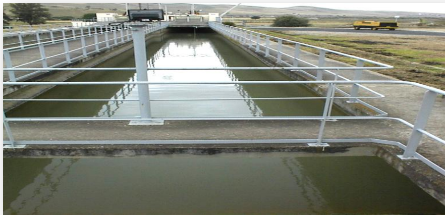
Figure 4: Opération de dessablage à la station de prétraitement de l'eau
