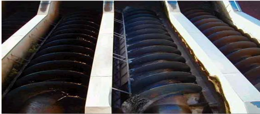
Figure 3: Opération de relevage de l'eau vers le dessableur au moyen des Vis d'Archimède.
