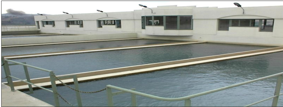
Figure 6: Filtration sur sable de l'eau à la station de traitement de l'eau de Aïn Nokbi
