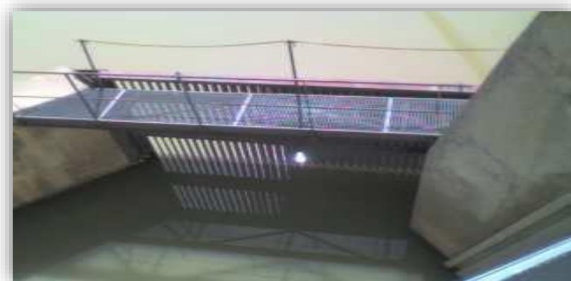
Figure 1 : opération de dégrillage
