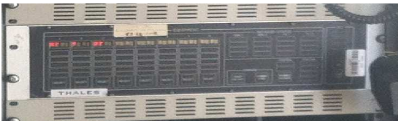
Figure 20 : Télécommande des équipements radionavigations
