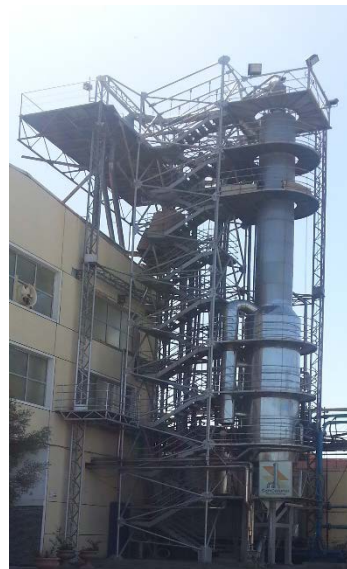
Photo 7 : colonne de désodorisation
