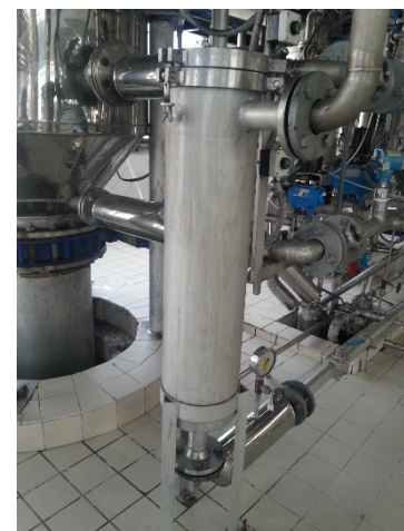
Photo 5 : Filtre à poches
