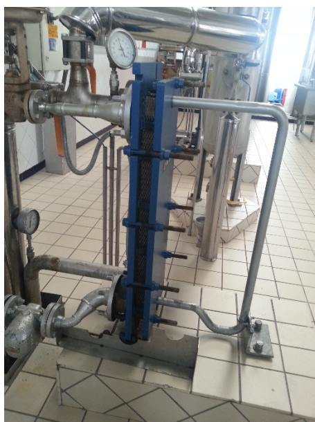
Photo 10 : Echangeur à plaques et joints (2)
