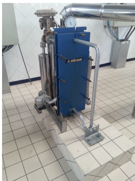
Photo 9 : Echangeur à plaques et joints (1)
